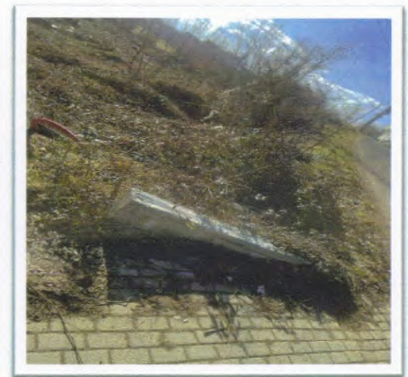
Foto 4. Pjesa problematike mbetet pjesa e kanalit afër ndërtesave
