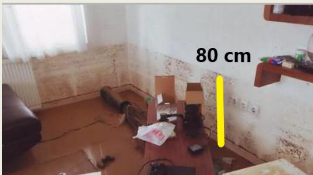
Niveli i ujit në katin përdhes të një shtëpie banimi në lagjen Porodin, shkaktuar nga vërshimi i lumit Stanishorka
