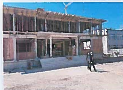
Ndërtimi i objektit të ri të shkollës "Liria" në Fortesë dhe sallës së edukatës fizike.
