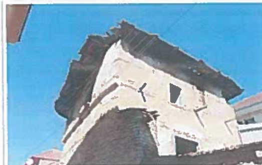
Dëmtimet në konstruksionin e kulmit
