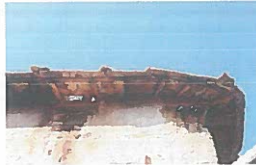
Dëmtimi në konstruksionin e kulmit dhe mbulesën
